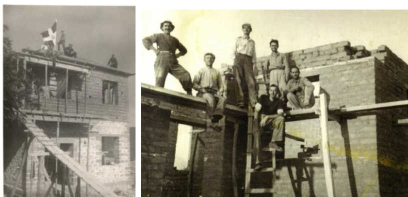
9. Στιγμές από την ανοικοδόμηση του νέου χωριού 1952-1953. Φτάνοντας κάθε φορά στην σκεπή, ύψωναν την Ελληνική σημαία (αγνώστου φωτογράφου παραχώρηση του Μορφωτικού Συλλόγου Δροσοπηγής « Η Πρόοδος»).
